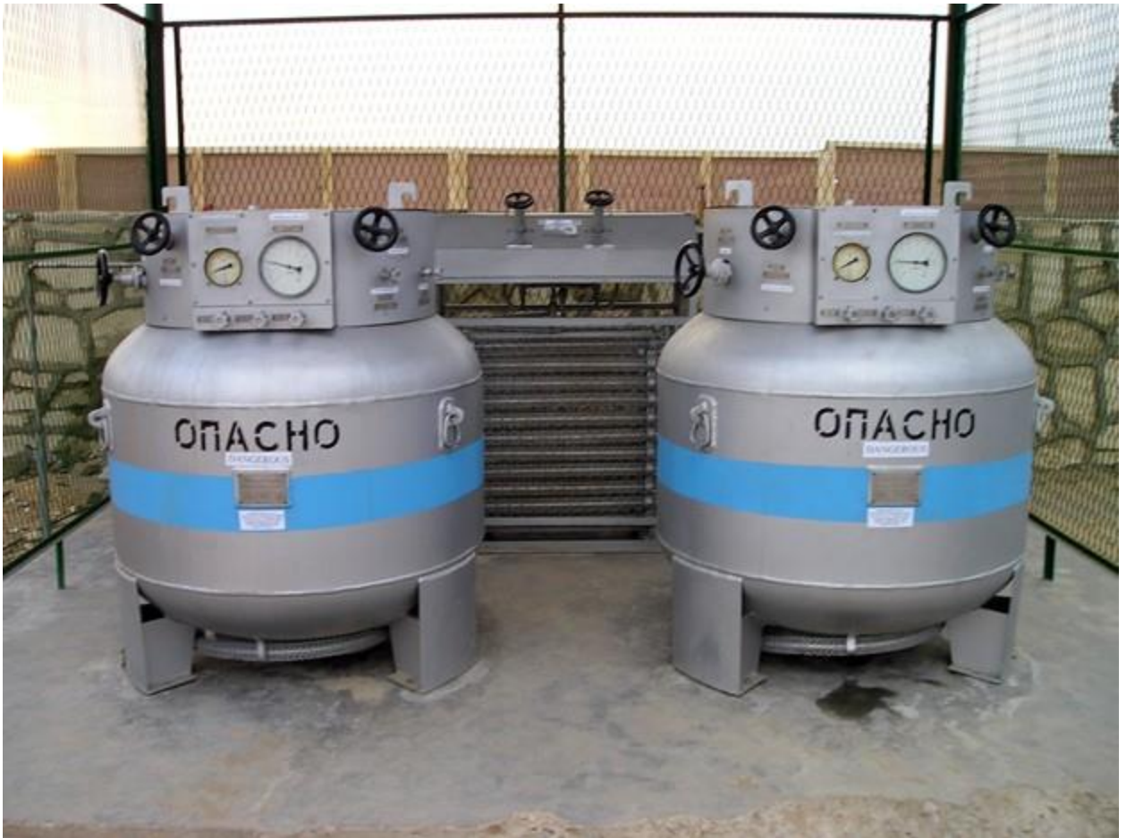
1.2-сурет – Азотты газификаторы негізіндегі станция
